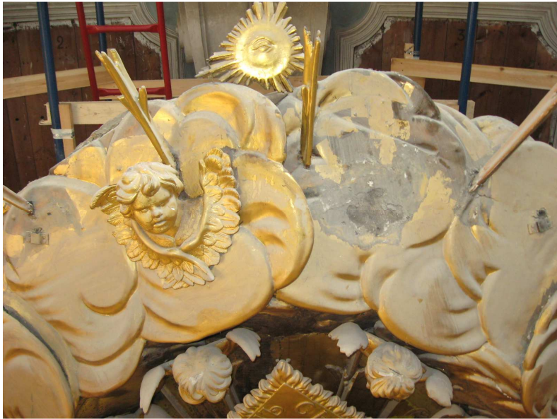
Ил. 3. Навершие иконостаса Петропавловского собора в Петербурге, 1722–1726, фотография автора, реставрационные работы 2012 года
