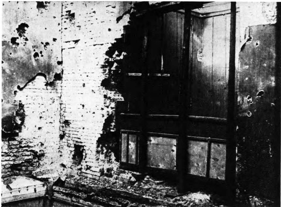
5. Разрушенный фугасной бомбой зал № 6 Третьяковской галереи. 1941
