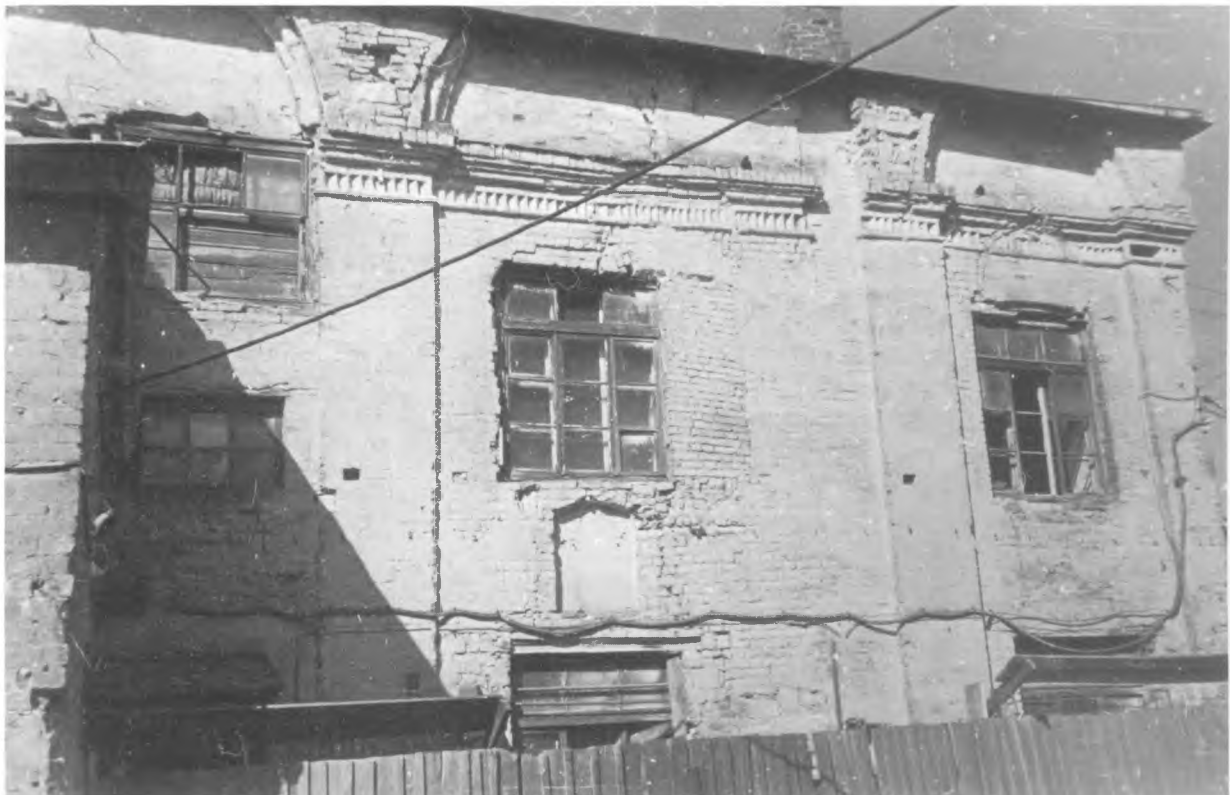
1979 г. Фрагмент южной стены, изуродованной переделками
