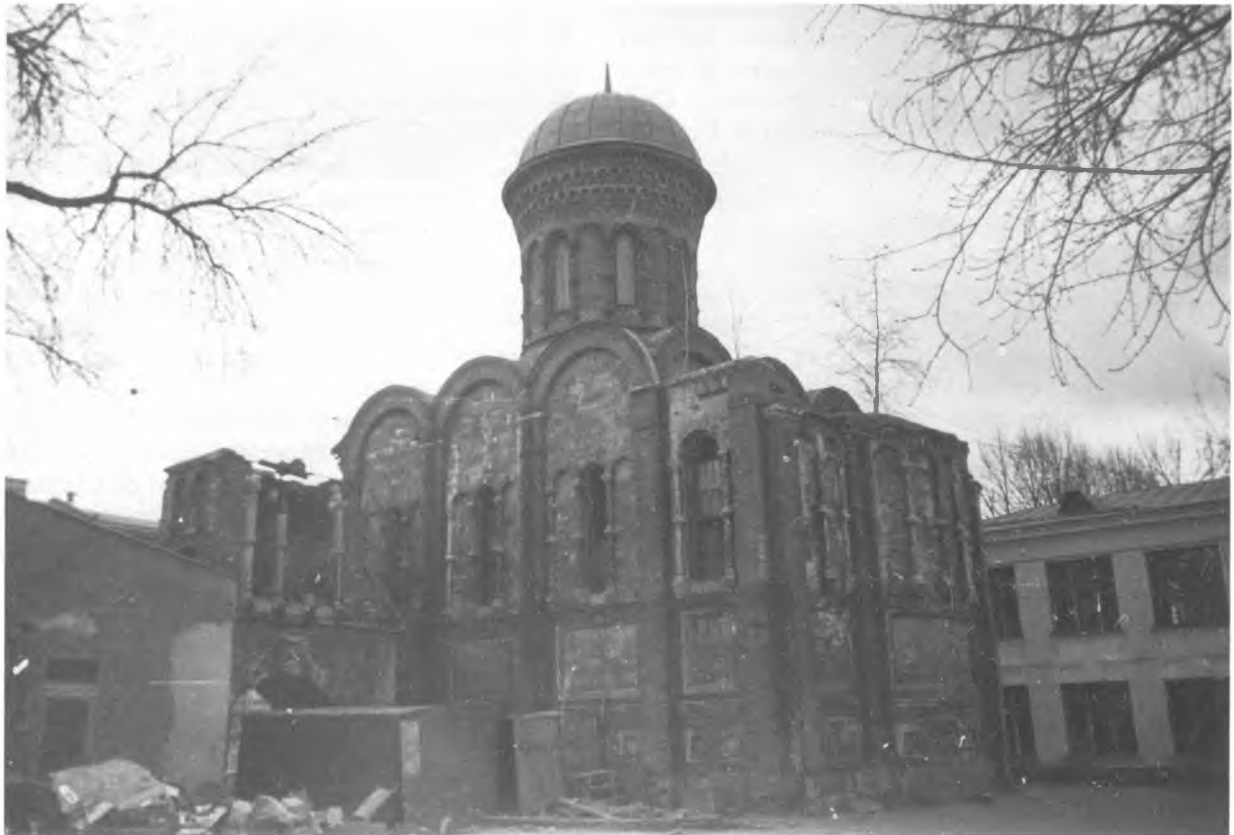
1979 г. Вид церкви Иверской иконы Божией Матери с юго-востока (слева — разрушающаяся колокольня)
