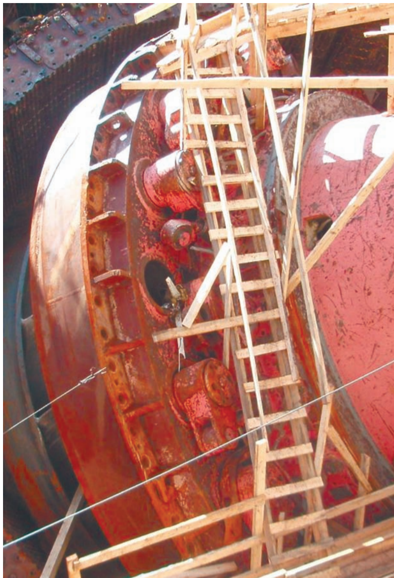
Рис. 3. Крышка ГА2 после откачки воды. Слева по окружности крышки идет фланец с помощью которого крышка крепилась с спиральной камере. Правее – цапфы лопаток направляющего аппарата с серьгами и сервоприводами. Одна из цапф вылетела при аварии (отерствие на переднем плане).
